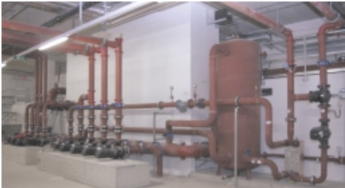
Hydraulische Weiche sowie Kältepumpensituation – unisoliert.
