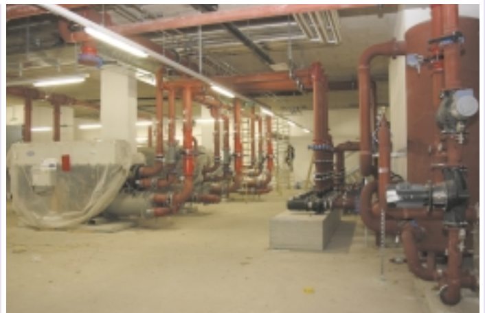
Blick in die Kältezentrale im Sommer 2004.
