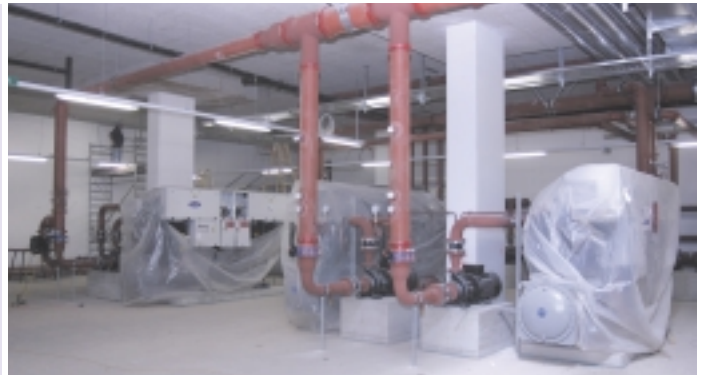
Die drei Kaltwassersätze des UKH Linz (oben).
