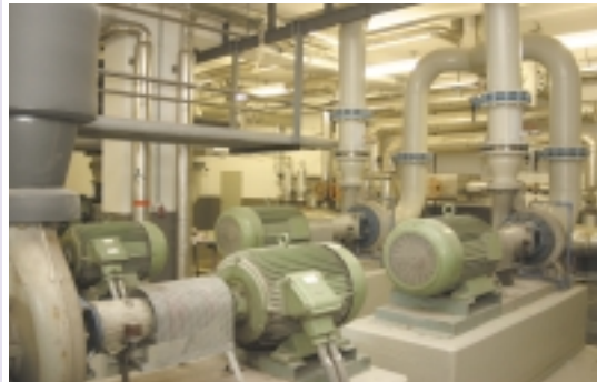
Kaltwasser- und Kühlwasserpumpen befinden sich im EG.
