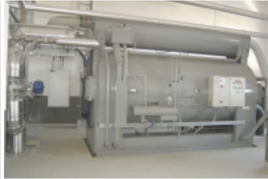
Die neue Absorptionskältemaschine im Bereich der Kältezentraleerweiterung.
