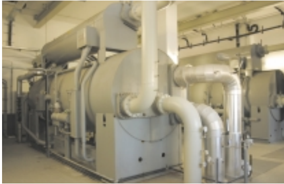
Die beiden Absorptionskältemaschinen des Kältezentralebestandes mit einer Leistung von je 2.387 kW.
