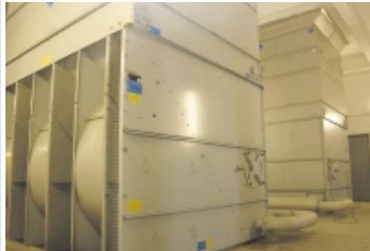
Im 2. OG sind die Kühltürme situiert.
