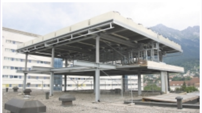
Die am Dach des ZVG aufgestellten Trockenkühler.
