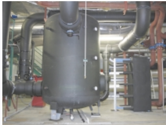
Blick auf die hydraulische Weiche und Fernkälteleitung sowie dem Plattenwärmetauscher in der Brunnenwasserleitung.
